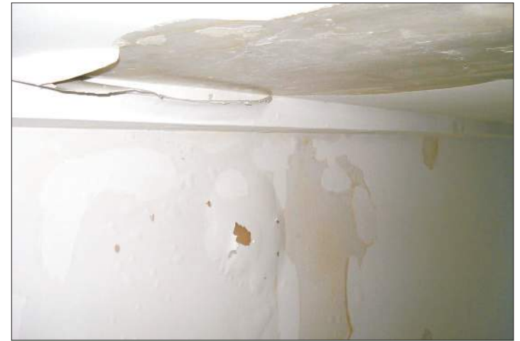
A responsabilidade pelos reparos causados pelo vazamento variam de acordo com a sua origem
